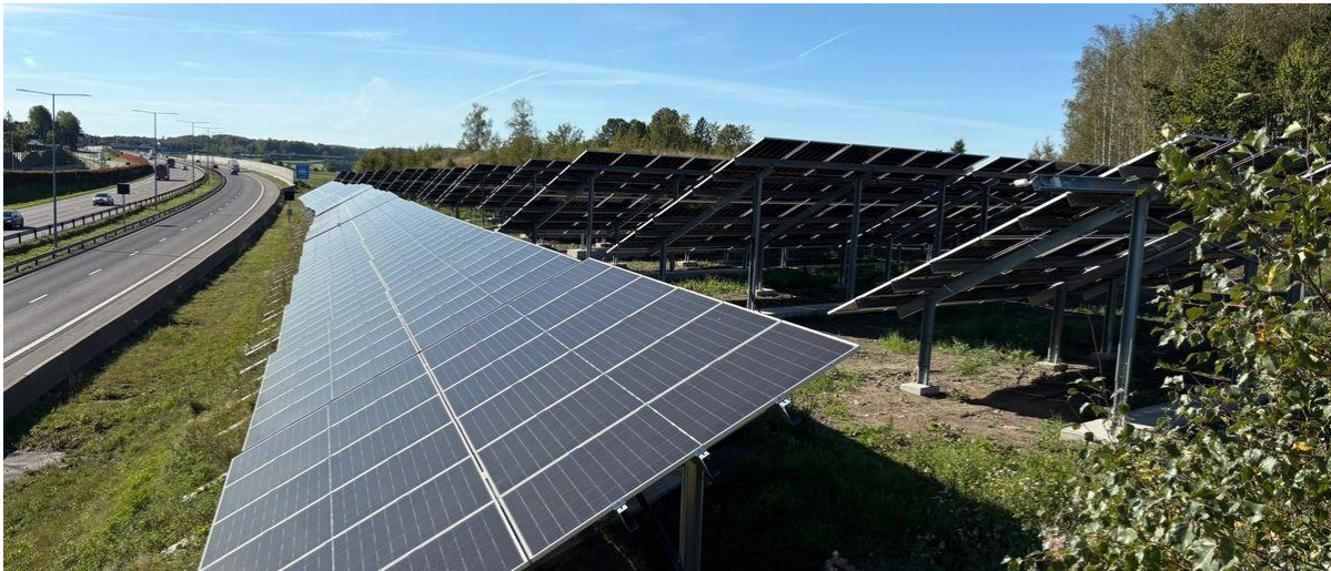
Figur 4-7 Furulund solkraftverk langs E-18 i Sandefjord
